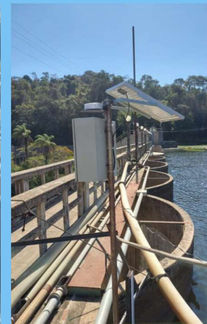
Equipamentos de medição e transmissão (PCD), posicionados sobre a barragem da PCH
