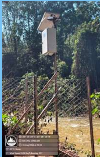
Equipamentos de coleta e transmissão de dados
