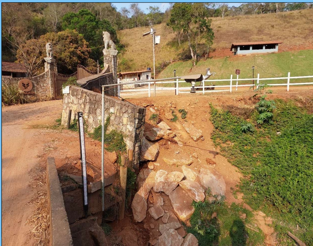
Vista geral do equipamento de coleta e transmissão de dados e réguas linimétricas
